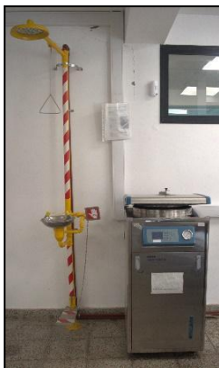
Ejemplo de equipo instalado en un laboratorio.
