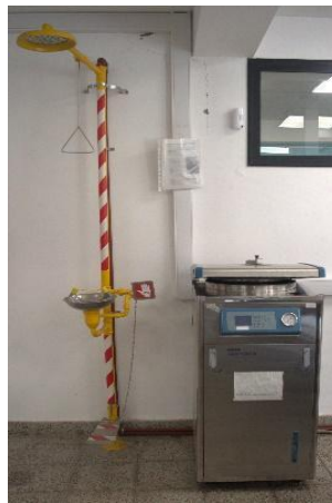
Ejemplo de equipo instalado en un laboratorio.
